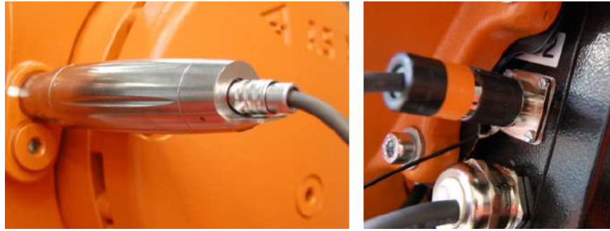
Fig. 14-23: Cable EMD, conectado
